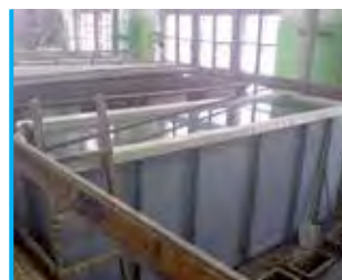
Футеровка ёмкостного оборудования
