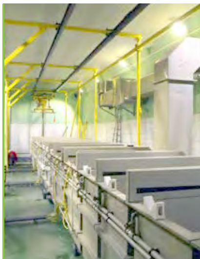
Комплекс оборудования участка гальванопокрытий
