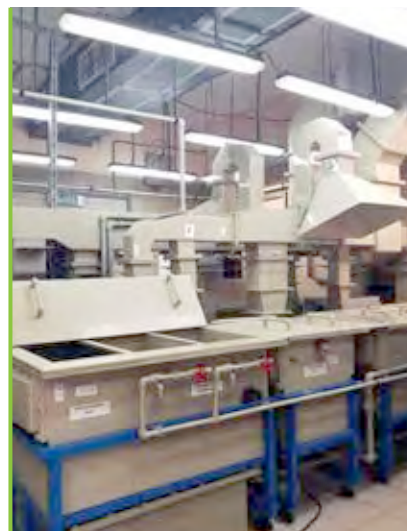
Комплекс оборудования участка гальванопокрытий
