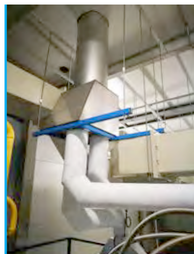
Парогазовый коллектор с жидкой теплоизоляцией
