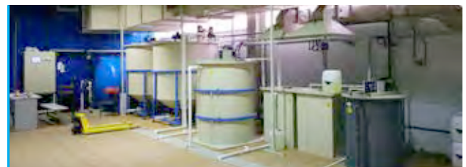
Комплекс оборудования очистных сооружений с автоматическим управлением
