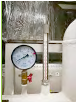
Группа приборов контроля температуры и давления
